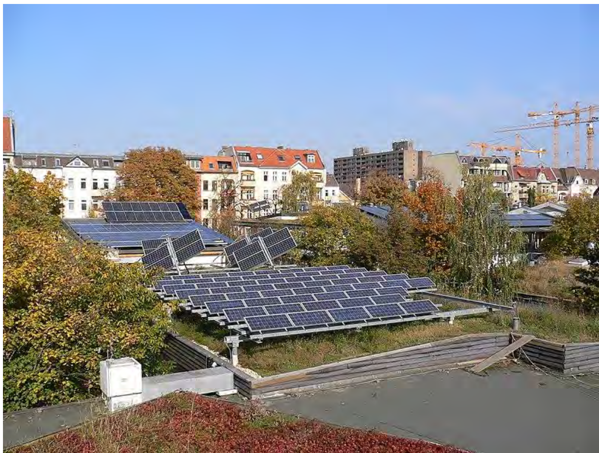
Berlín – Tempelhof, fotovoltaické panely a zelená střecha na UFA Fabrik. Zdroj: Wikimedia Commons (autor: Georg Slickers)
