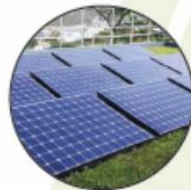
FOTOVOLTAIČKÉ PANELE NA STŘECHÁCH OBJEKTŮ
