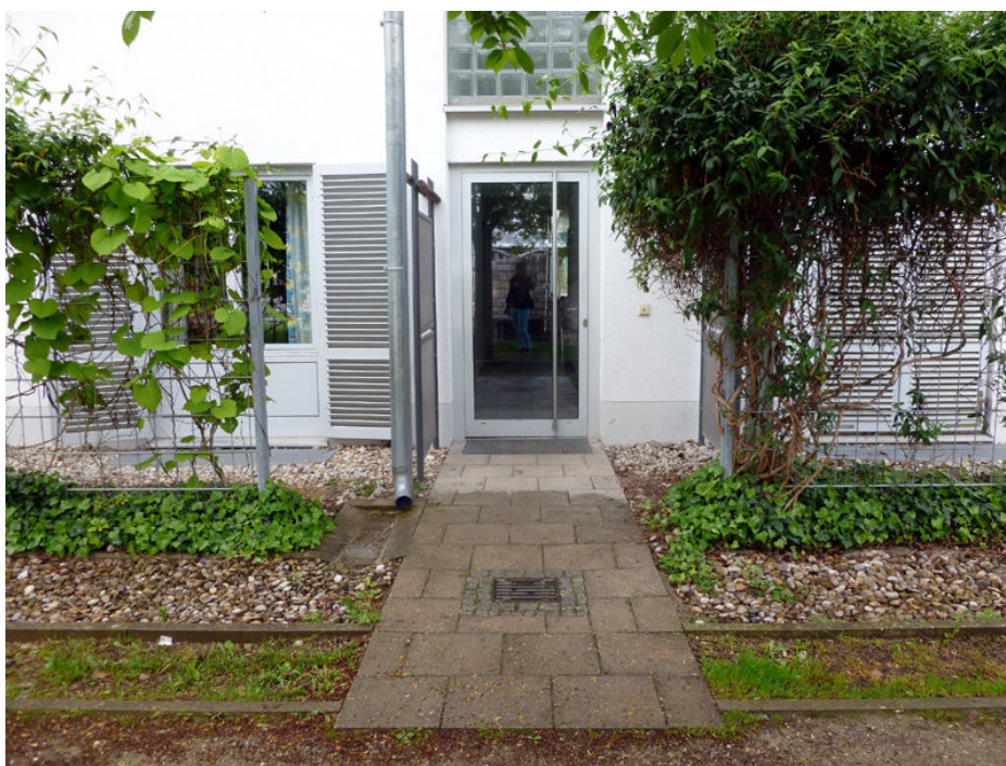
Odvádění dešťové vody ze střešních ploch do štěrkového průlehu.
